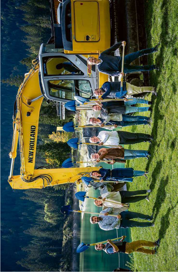
Eriecherung und fröhliche Gesichter am Spatenstich von vergangener Woche. Ab sofort wird am Caumasee gebaut.
